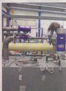
Ein Komplett-Versorgungssystem für Schmierölversorgung
